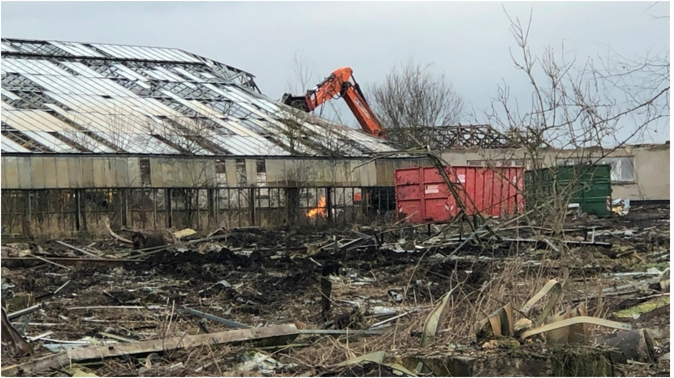
Schandfleck: Die Gewächshäuser an der L33 zwischen Gorgast und Golzow.
